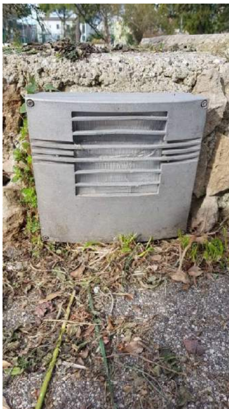
Figura 12 vista dei corpi illuminanti a parete DA SOSTITUIRE
