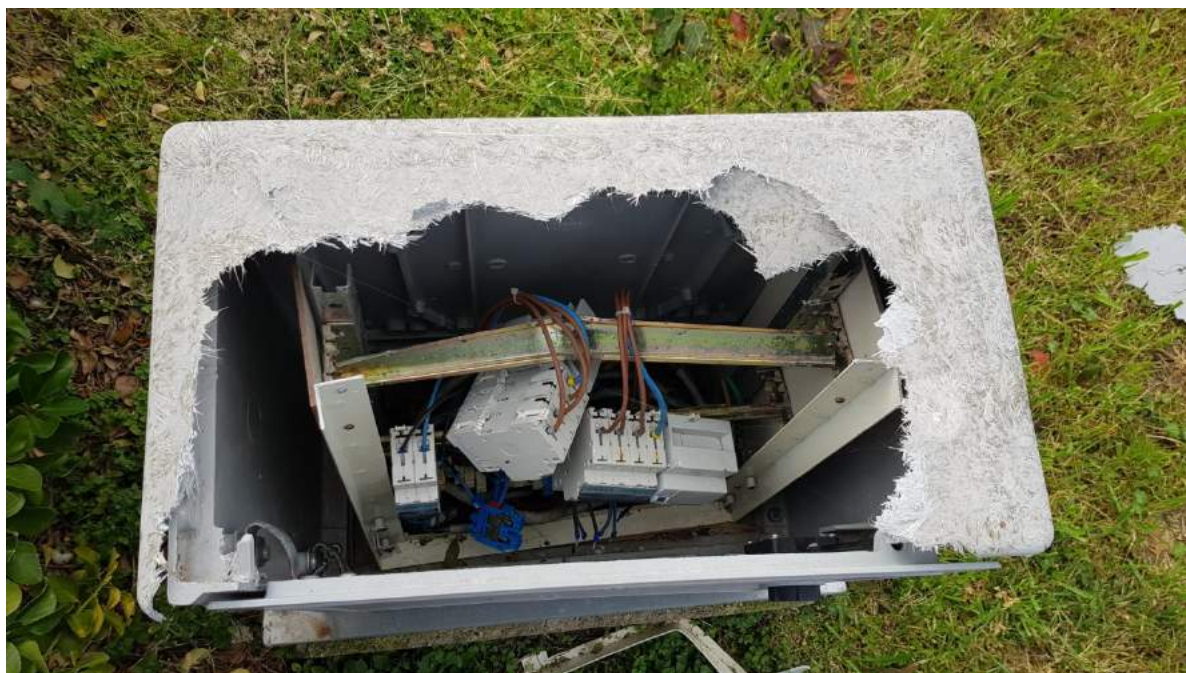
Figura 15 vista dei quadri elettrici DA SOSTITUIRE
