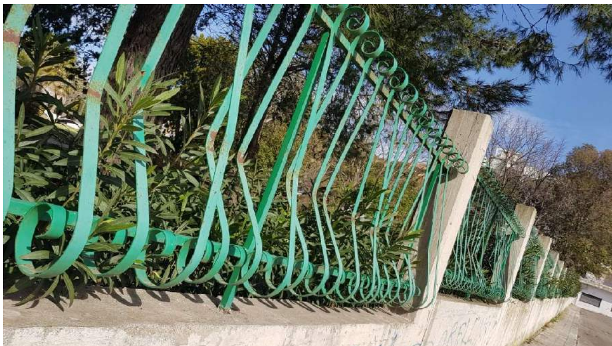
Figura 8 vista della ringhiera deteriorata
