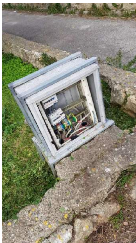
Figura 14 vista dei quadri elettrici DA SOSTITUIRE
