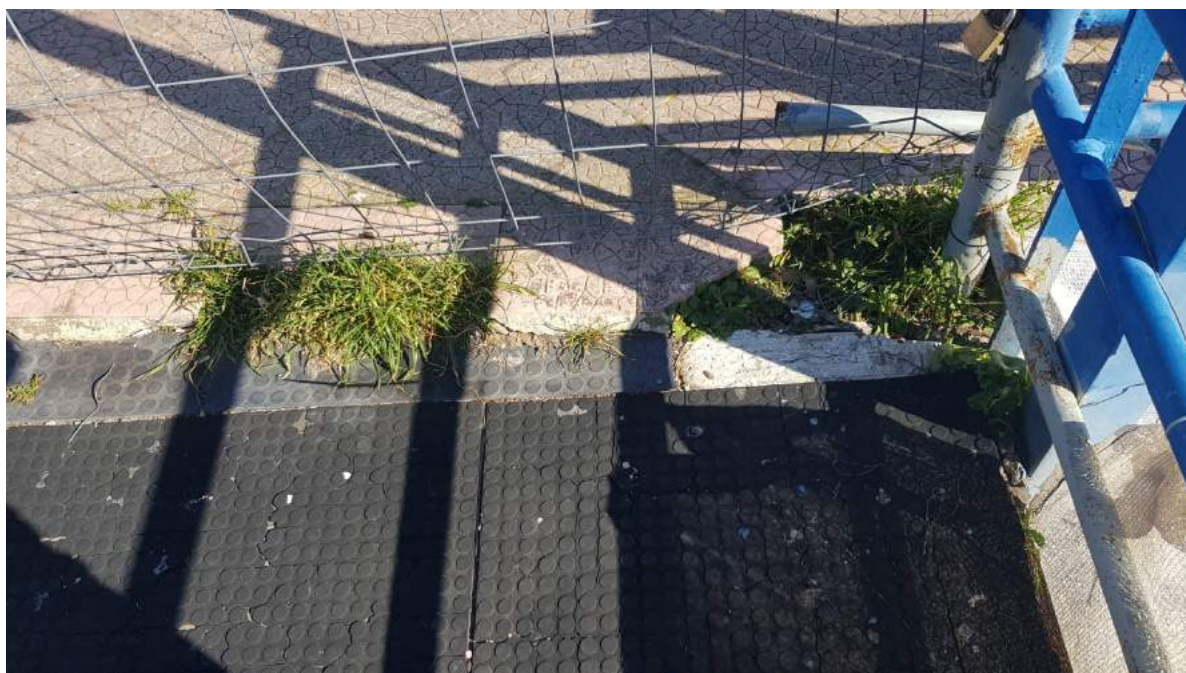
Figura 6 vista tra livello passeggiata di via Roma e scala di accesso alla villa_ presenza di vegetazione spontanea
