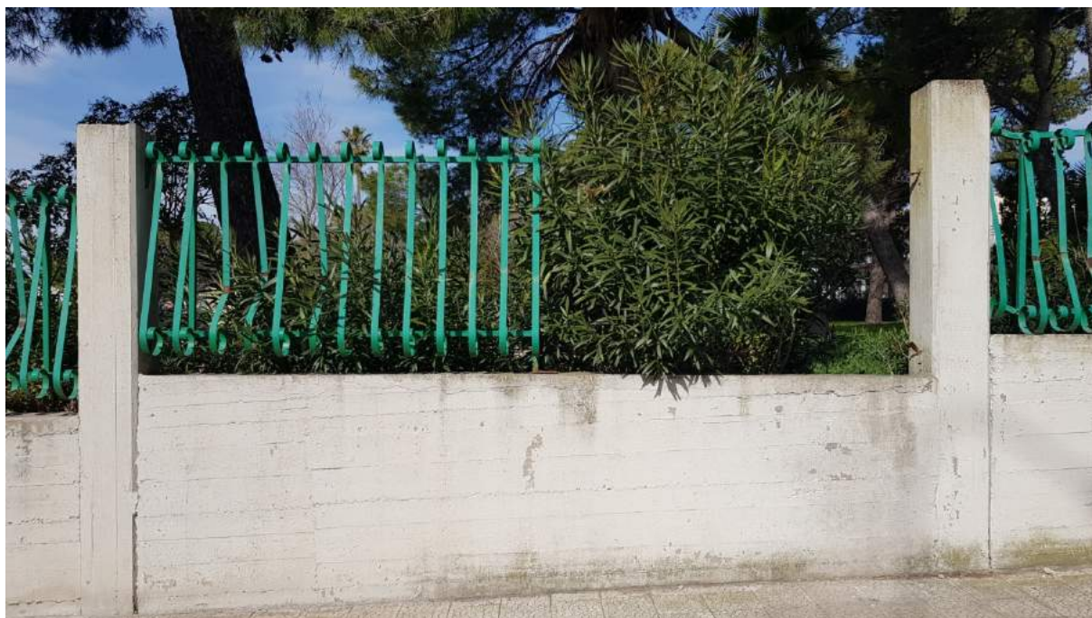
Figura 9 vista della ringhiera mancante in parte
