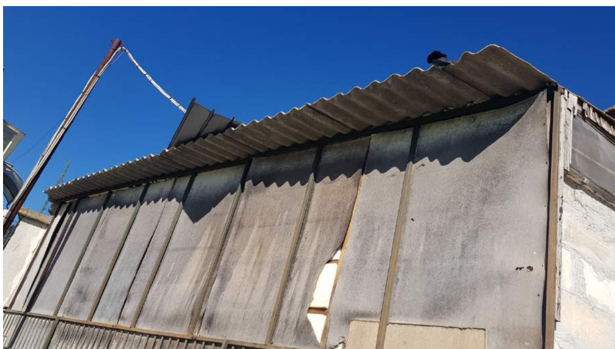
Figura 20 presenza di amianto nell'area "ex-ristorante"
