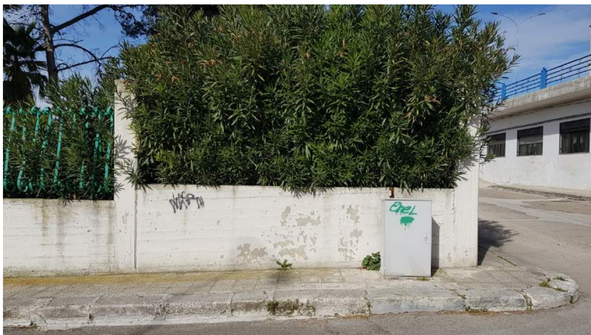
Figura 10 vista della ringhiera mancante totalmente
