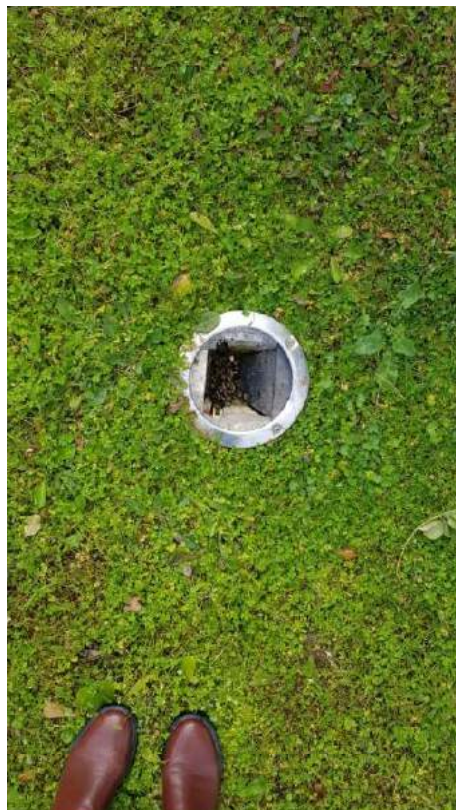
Figura 13 vista dei corpi illuminanti a pavimento DA SOSTITUIRE
