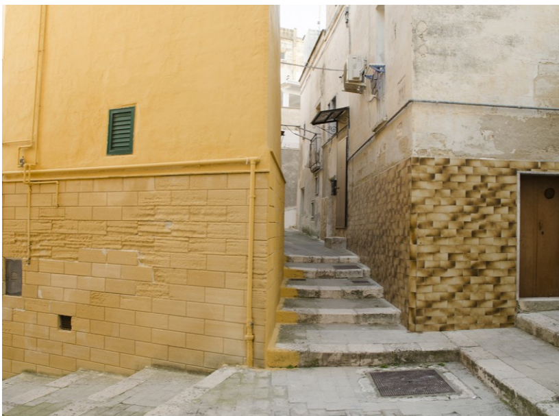
Foto 7 - esempi di rivestimenti incongrui
