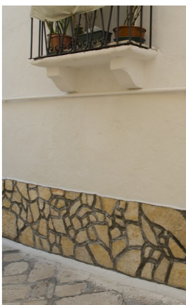
Foto 44 e 45 - elementi incongrui in facciata
