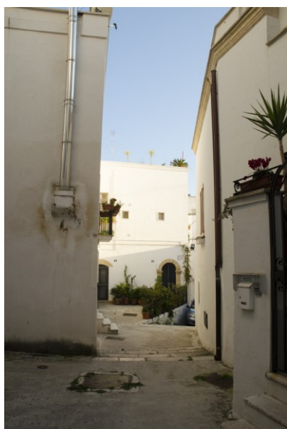
Foto 43 - condutture impiantistiche in facciata
